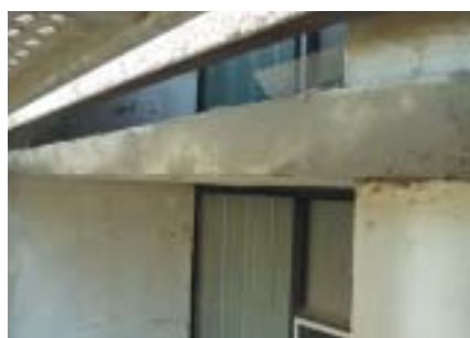
5) Jemné vyspravení železobetonové konstrukce ARDEX B14. Povrch může být štukový nebo vyhlazený
