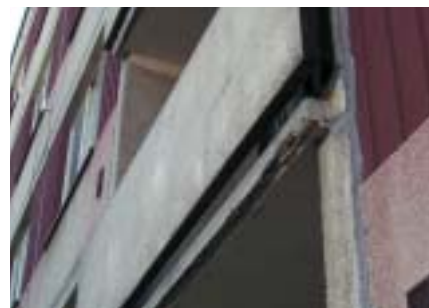
1) Poškození železobetonových konstrukcí způsobené povětrnostními vlivy
